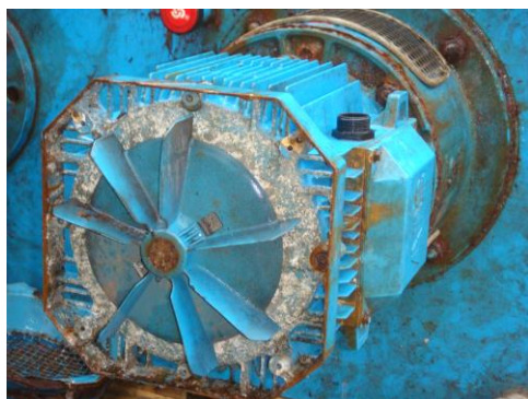
Defekter Elektromotor Nr. 4
