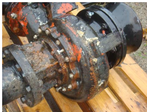
Defekte Pumpe Nr. 4
