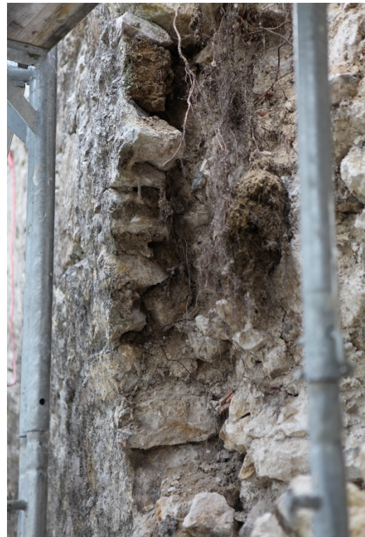
Ablösung Mauerschale Nord Stadtmauer West
