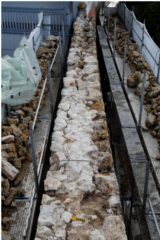
Riss unter der Mauerkrone Stadtmauer West
