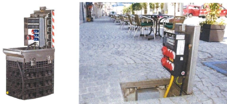
Abbildung 2: Beispiel Unterflur Elektrand (Energiesäule Gifas Campetto)
