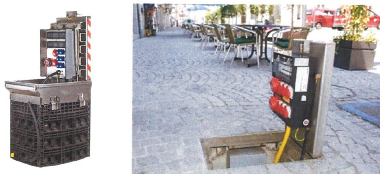
Abbildung 2: Beispiel Unterflur Elektrand (Energiesäule Gifas Campetto)
