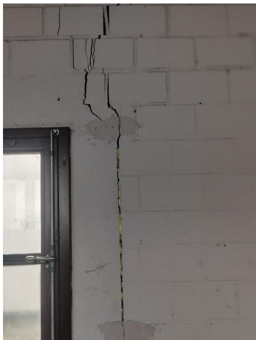
Abb7: Riss Innenraum Südfassade
