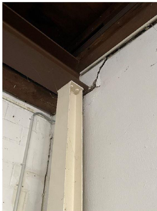
Abb6: Riss Innenraum Aussenwand
