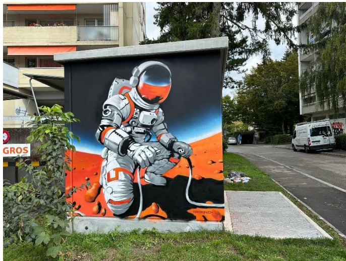
Abbildung 1: Neue Trafostation Milanweg
