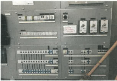
Elektroinstallationen Werkstatt (ca. 2000)
